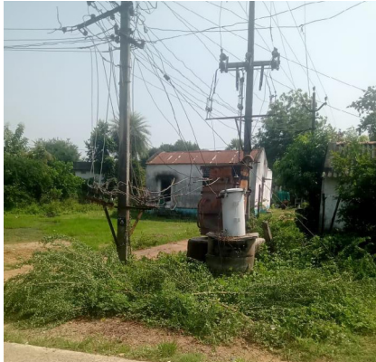
ట్రాన్స్ ఫార్మర్ చుట్టూ పెరిగిన పిచ్చిమొక్కలు
